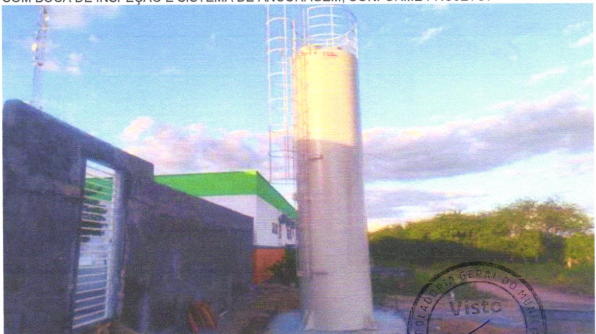
FOTO 26 - RESERVATÓRIO DE CHAPA DE AÇO CARBONO E SOLDA INTERNA E EXTERNA, COM BOCA DE INSPEÇÃO E SISTEMA DE ANCORAGEM, CONFORME PROJETO.
